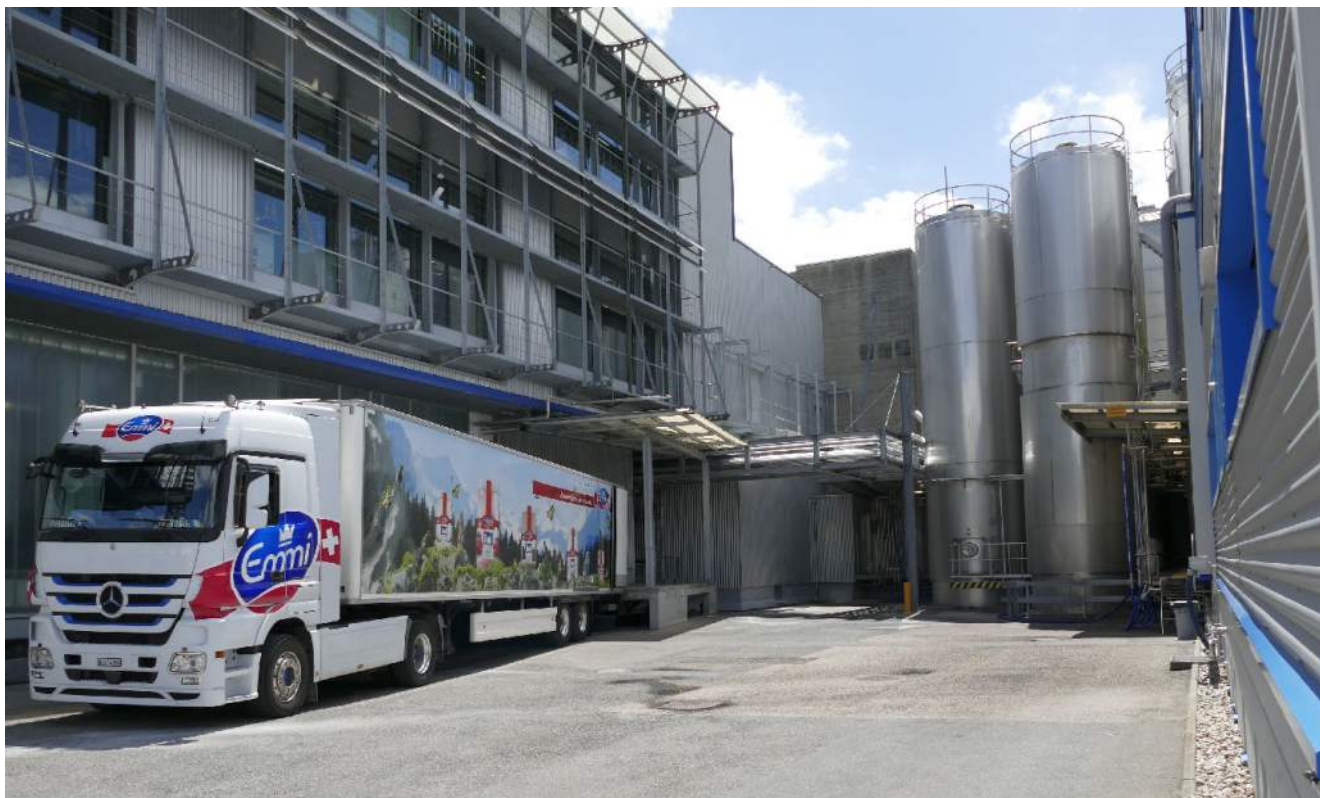
Für den Neubau im Innenhof mussten die Trassen mit den Versorgungsleitungen neu verlegt werden. Gleichzeitig wurde die Situation im Hinblick auf getrennte, kreuzungsfreie Personen- und Warenflüsse verbessert.
